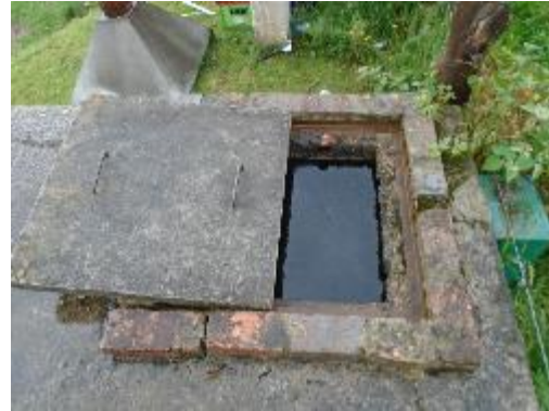
Fotografía 42. Tanque de almacenamiento
