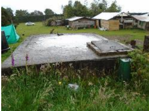
Fotografía 43. Tanque de almacenamiento
