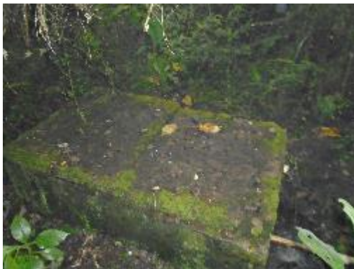
Fotografía 9. Desarenador (Vista Superior)
