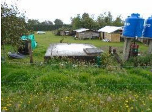
Fotografía 41. Tanque de almacenamiento
