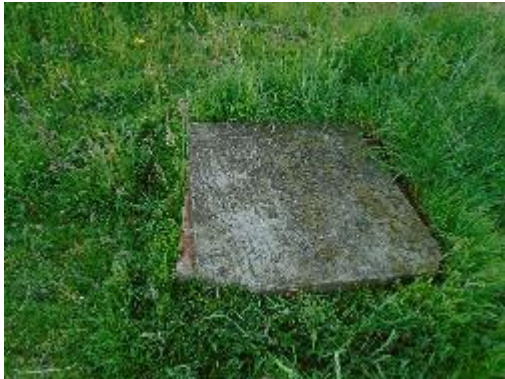
Fotografía 40. Caja, Válvula de corte 3
