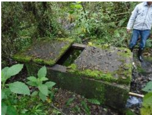
Fotografía 7. Desarenador (Vista Frontal)
