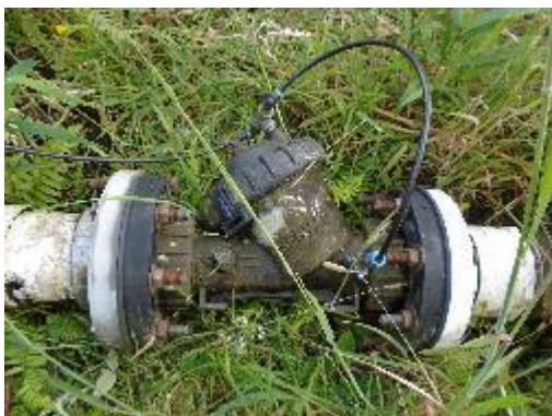
Fotografía 29. Válvula de control de nivel
