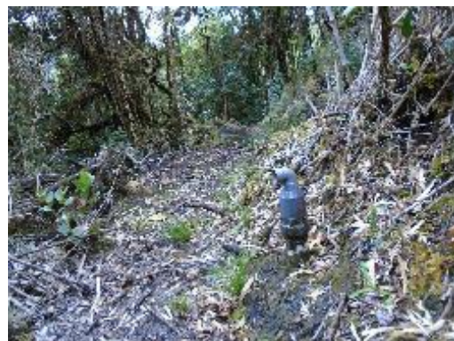
Fotografía 18. Vista Válvula de Aire
