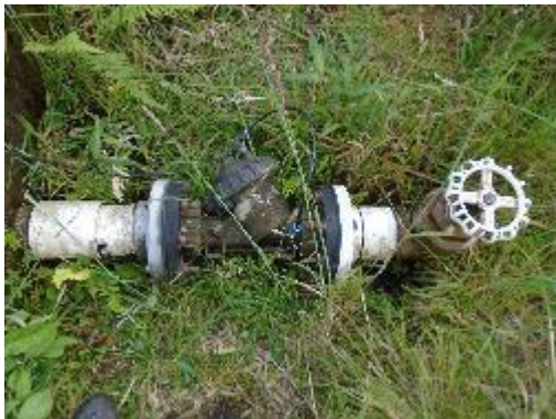
Fotografía 27. Vista Cámara de Quiebre- Válvulas
