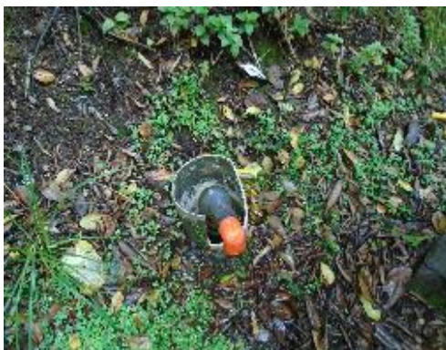
Fotografía 17. Vista Válvula de Aire
