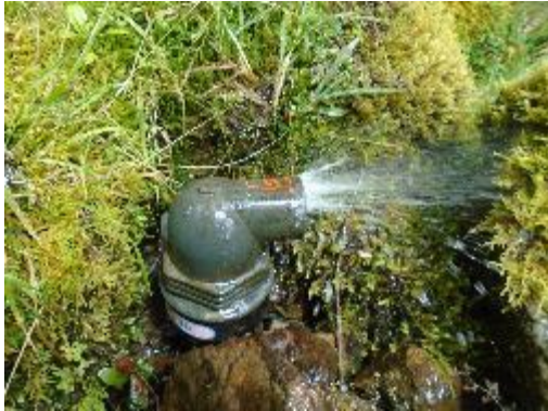
Fotografía 19. Vista Válvula de Aire
