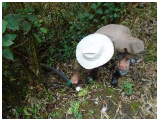
Fotografía 23. Vista Válvula de Purga
