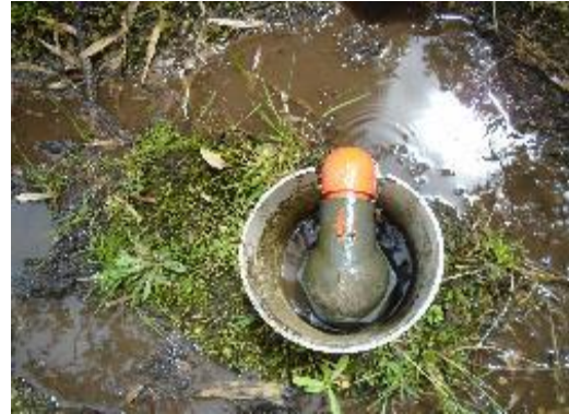
Fotografía 20. Vista Válvula de Aire
