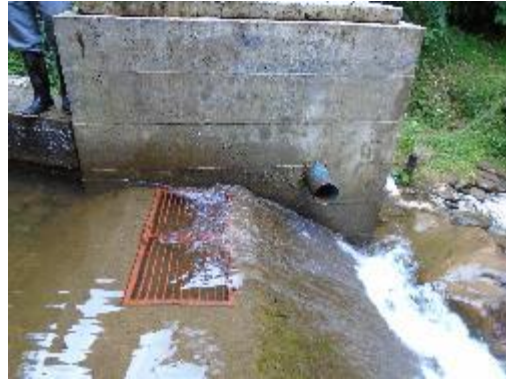
Fotografía 2. Vista lateral de la rejilla de la Bocatoma
