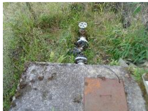
Fotografía 30. Vista Cámara de Quiebre
