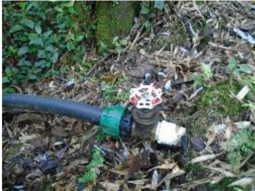
Fotografía 25. Vista Válvula de Purga
