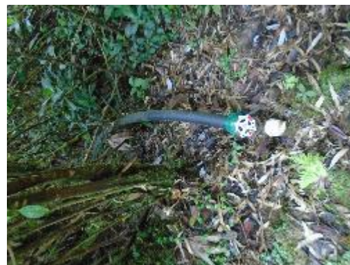
Fotografía 24. Vista Válvula de Purga
