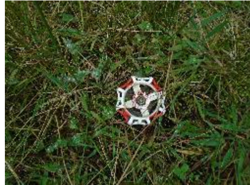
Fotografía 26. Vista Válvula de Purga
