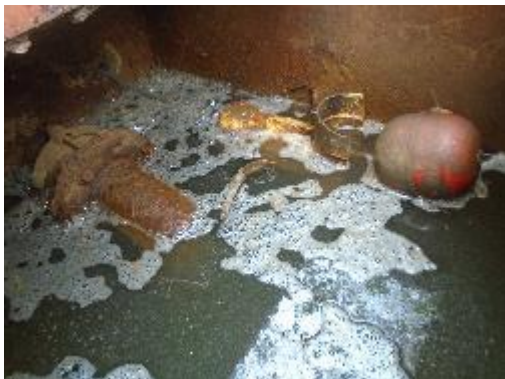
Fotografía 35. Caja húmeda, Cámara de quiebre 3
