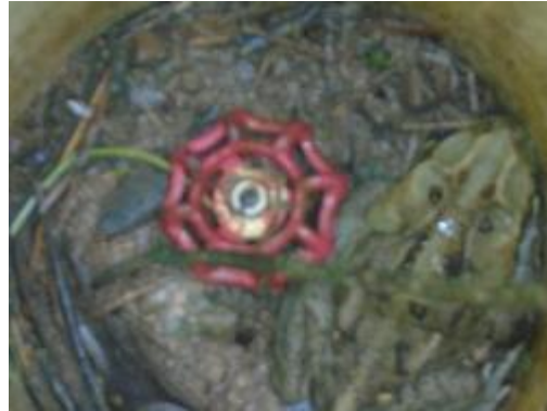
Fotografía 26. Válvula de corte
