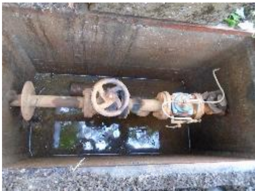
Fotografía 41. Caja de válvulas, Cámara de quiebre 7
