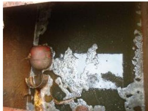
Fotografía 36. Caja húmeda, Cámara de quiebre 3
