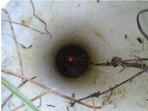
Fotografía 25. Válvula de corte
