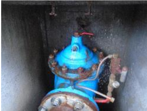
Fotografía 31. Válvula reguladora de nivel, Cámara de quiebre 1
