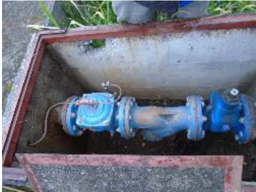
Fotografía 37. Válvula reguladora de nivel, Cámara de quiebre 4
