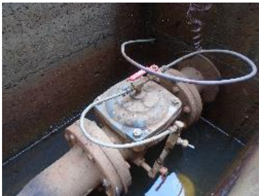
Fotografía 33. Válvula reguladora de nivel, Cámara de quiebre 3
