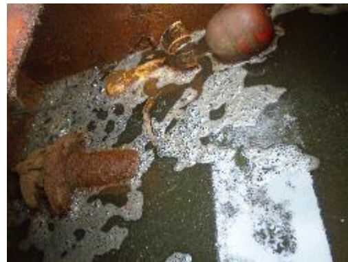
Fotografía 34. Caja húmeda, Cámara de quiebre 3
