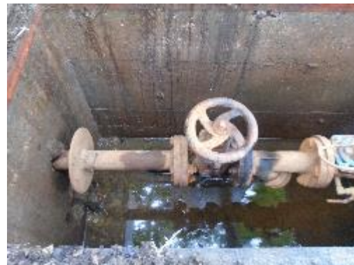
Fotografía 42. Válvula de corte, Cámara de quiebre 7
