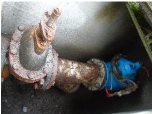
Fotografía 29. Caja de válvulas, Cámara de quiebre 1
