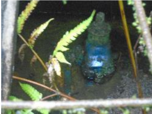
Fotografía 5. Válvula de salida
