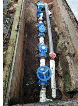
Macro - medidor dañado (fuera de servicio)
