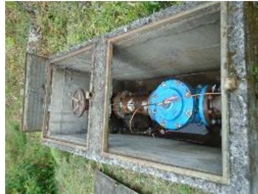
Fotografía 57. Vista Lateral, caja de válvulas, tanque de almacenamiento
