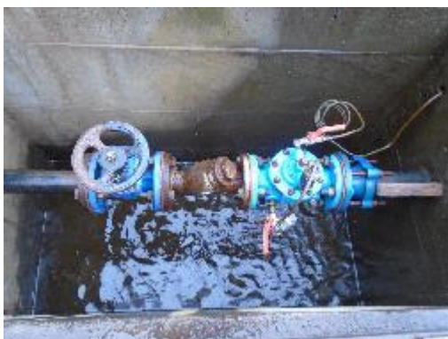
Fotografía 50. Vista Superior, caja de válvulas, Cámara de quiebre 2
