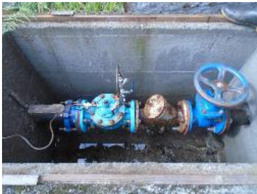
Fotografía 54. Vista Lateral, caja de válvulas, Cámara de quiebre 5
