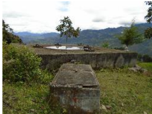
Fotografía 65. Tanque de reserva
