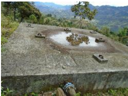
Fotografía 66. Tanque de reserva
