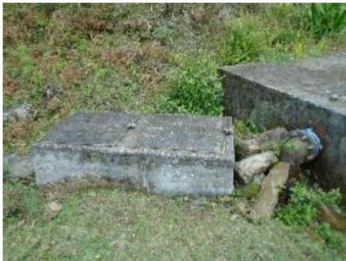
Fotografía 64. Unión de la cámara de quiebre con el tanque de reserva
