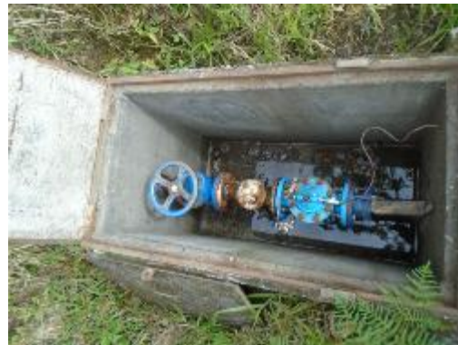
Fotografía 55. Caja de válvulas, Cámara de quiebre 5
