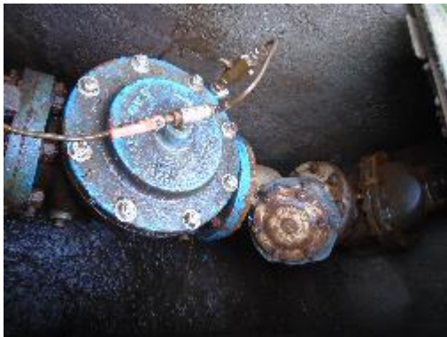
Fotografía 48. . Vista Lateral, caja de válvulas, Cámara de quiebre 1
