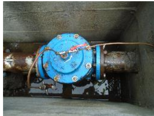
Fotografía 59. Válvula reguladora de nivel, tanque
