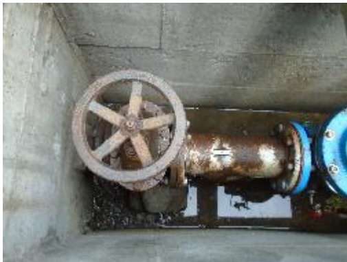
Fotografía 58. Válvula de corte, Tanque
