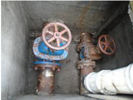
Fotografía 68. Válvula de salida (Izquierda) y Válvula de lavado (Derecha) del tanque de reserva
