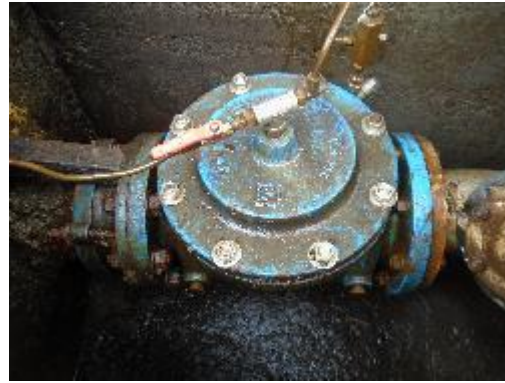
Fotografía 47. Válvula control de nivel, Cámara de quiebre 1
