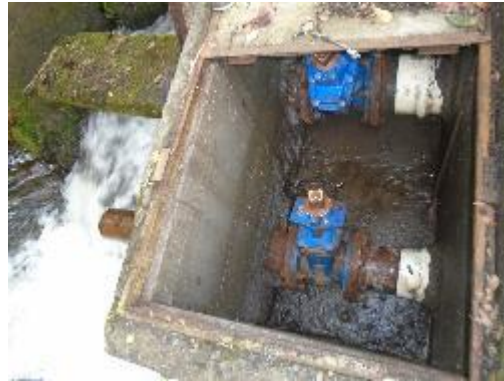
Fotografía 2. Vista Frontal de Caja de válvulas
