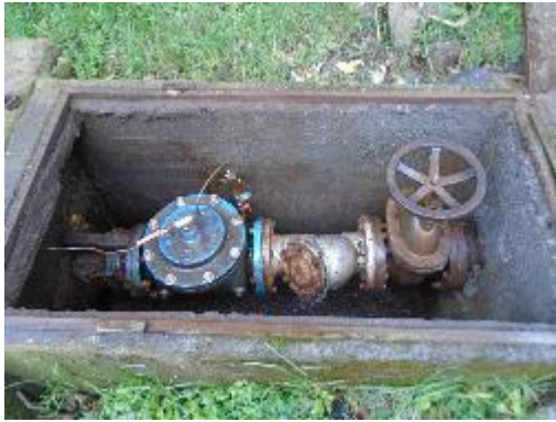
Fotografía 46. Vista Lateral, caja de válvulas, Cámara de quiebre 1
