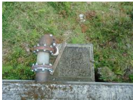
Fotografía 67. Tubería de rebose del tanque de reserva
