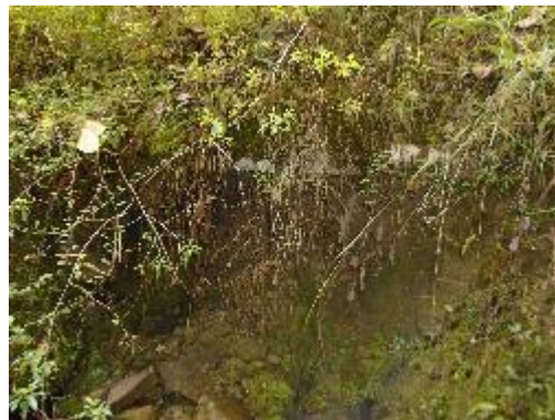
Fotografía 16. Aducción problema de estabilidad
