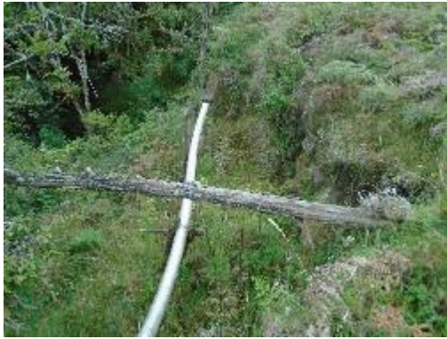
Fotografía 17. Aducción problema de estabilidad
