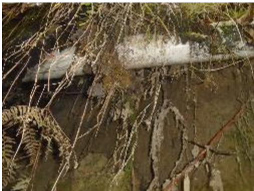
Fotografía 15. Aducción problema de estabilidad
