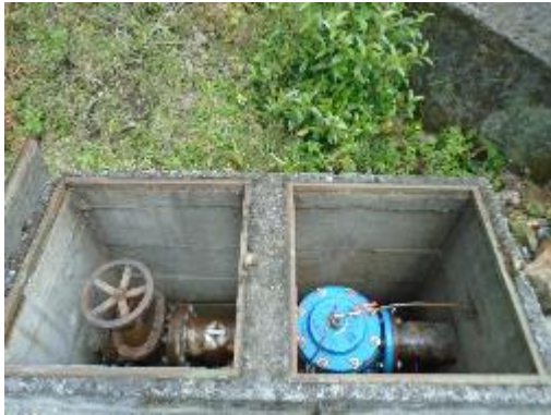
Fotografía 56. Vista Lateral, caja de válvulas, tanque de almacenamiento
