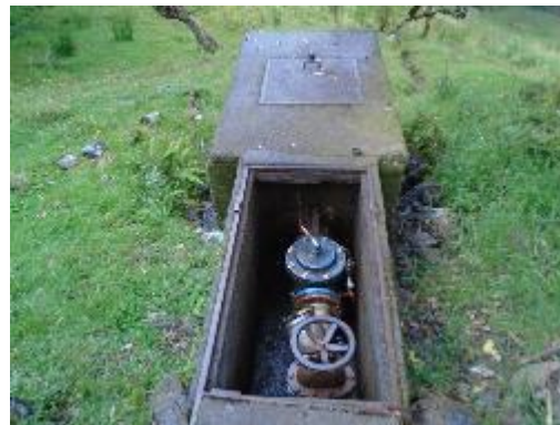
Fotografía 45. Vista Superior, caja de válvulas, Cámara de quiebre 1
