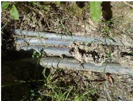
Fotografía 22. Mangueras de conducción
