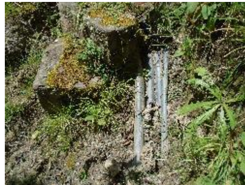
Fotografía 21. Mangueras de conducción
