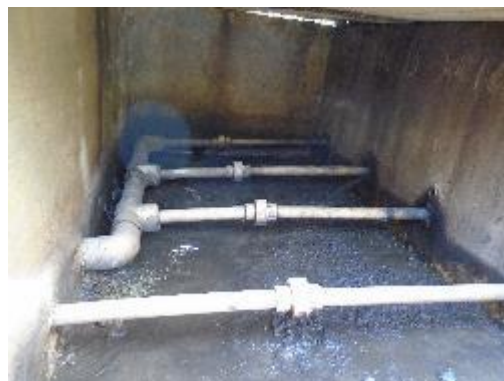
Fotografía 19. Línea de conducción a la salida del desarenador
