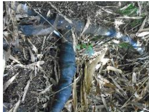
Fotografía 27. Derivación a ramal
