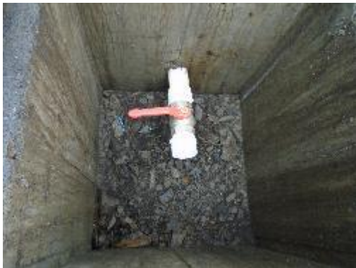
Fotografía 27. Hidrante para Bomberos
