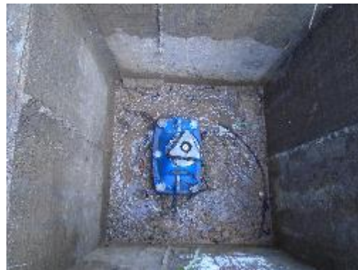
Fotografía 40. Vista Superior, Válvula de corte 3 (entre VV6 y VV7)
