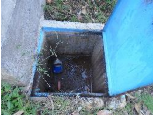
Fotografía 41. Vista Superior, Válvula de corte 4 (Seguida a la CC1)
