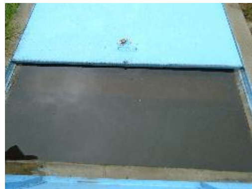
Fotografía 12. Zona de sedimentación Desarenador 1
