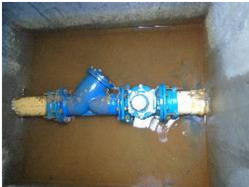
Fotografía 21. Caja del sistema de macro medición
