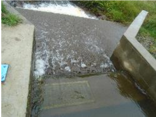
Fotografía 3. Rejilla de Bocatoma 1
