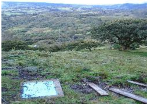
Fotografía 29. Caja, Hidrante para Bomberos
