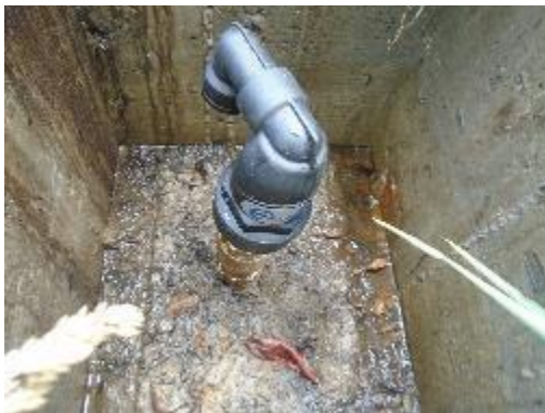
Fotografía 37. Vista Superior, Válvula ventosa 2
