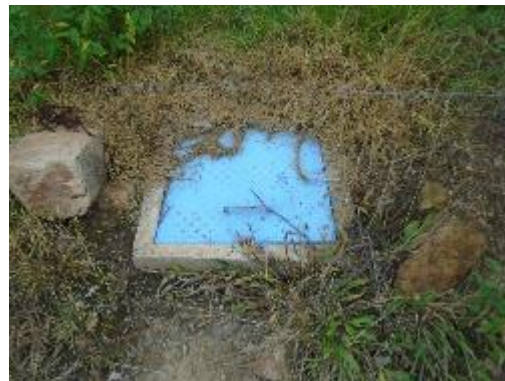
Fotografía 38. Vista Superior, Válvula ventosa 2
