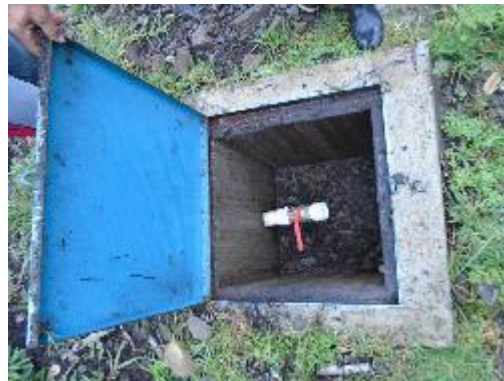
Fotografía 28. Hidrante para Bomberos
