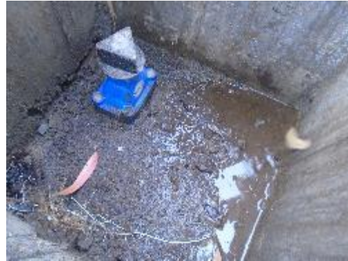
Fotografía 42. Válvula de corte 4 (Seguida a la CC1)
