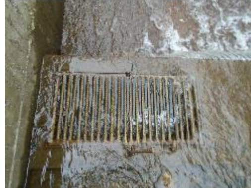
Fotografía 10. Rejilla de Bocatoma 2
