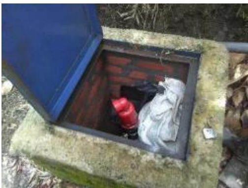
Fotografía 10. Vista Válvula ventosa
