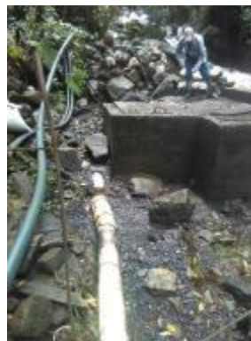
Fotografía 4. Tubería de aduccion
