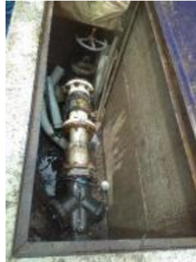
Fotografía 16. Vista Cámara de quiebre
