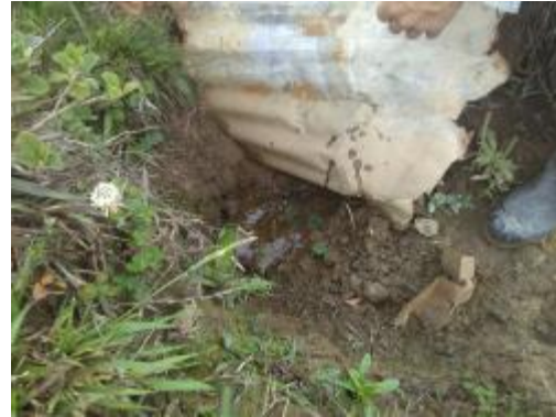
Fotografía 13. Vista Válvula ventosa
