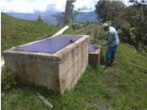
Fotografía 15. Vista Cámara de quiebre
