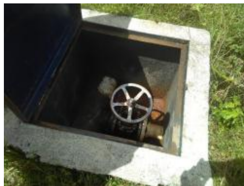
Fotografía 11. Vista Válvula de purga
