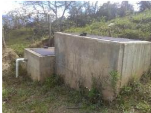
Fotografía 18. Vista Cámara de quiebre
