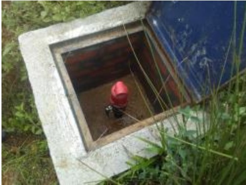
Fotografía 12. Vista Válvula ventosa
