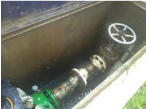
Fotografía 17. Vista Cámara de quiebre
